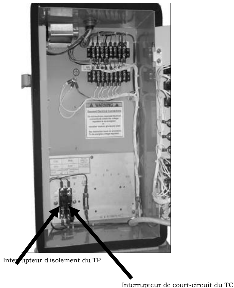
Fig. 9 Interrupteur de court-circuit du TC et interrupteur d'isolement du TP
